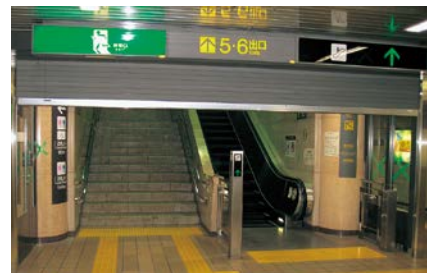
防火防煙シャッター
