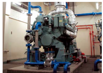
非常用発電機
