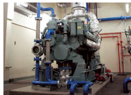
非常用発電機
