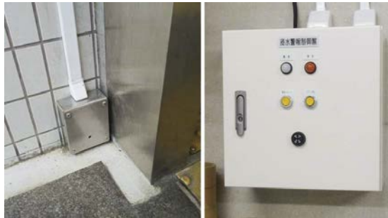
浸水警報装置
