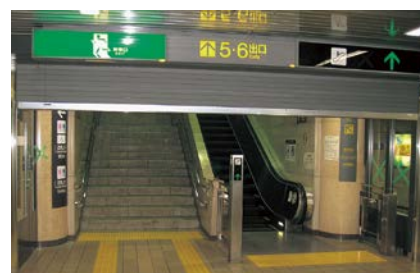
防火防煙シャッター
