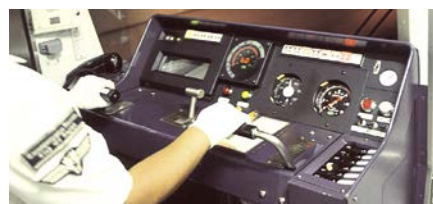
ATC（自動列車制御装置）
