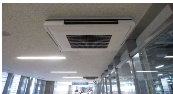
※名古屋駅バスターミナルの空調設備
