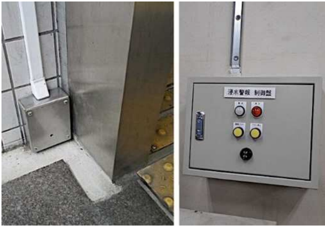
浸水警報装置
